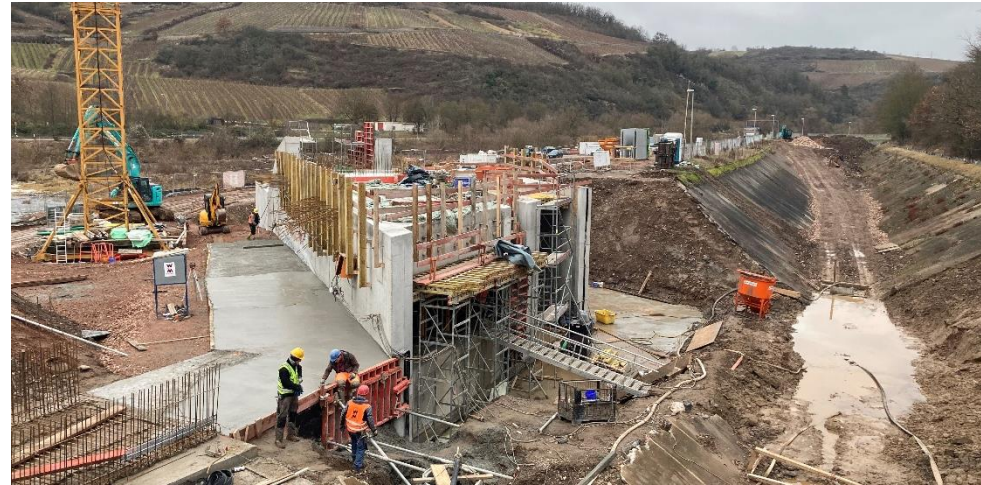
Wasserkraftanlage in Niederhausen
